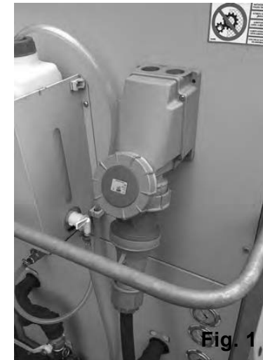
Fig. 1 - Connecteur d'entrée 400 volts, 63 ampères, 5 pôles, qui se trouve sur le groupe froid de 50 KW
